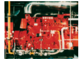
Edelstahlschläuche an Versorgungsleitungen am Gasmotor.
