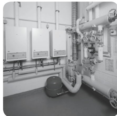
Heizkessel, in Kaskade geschaltet
